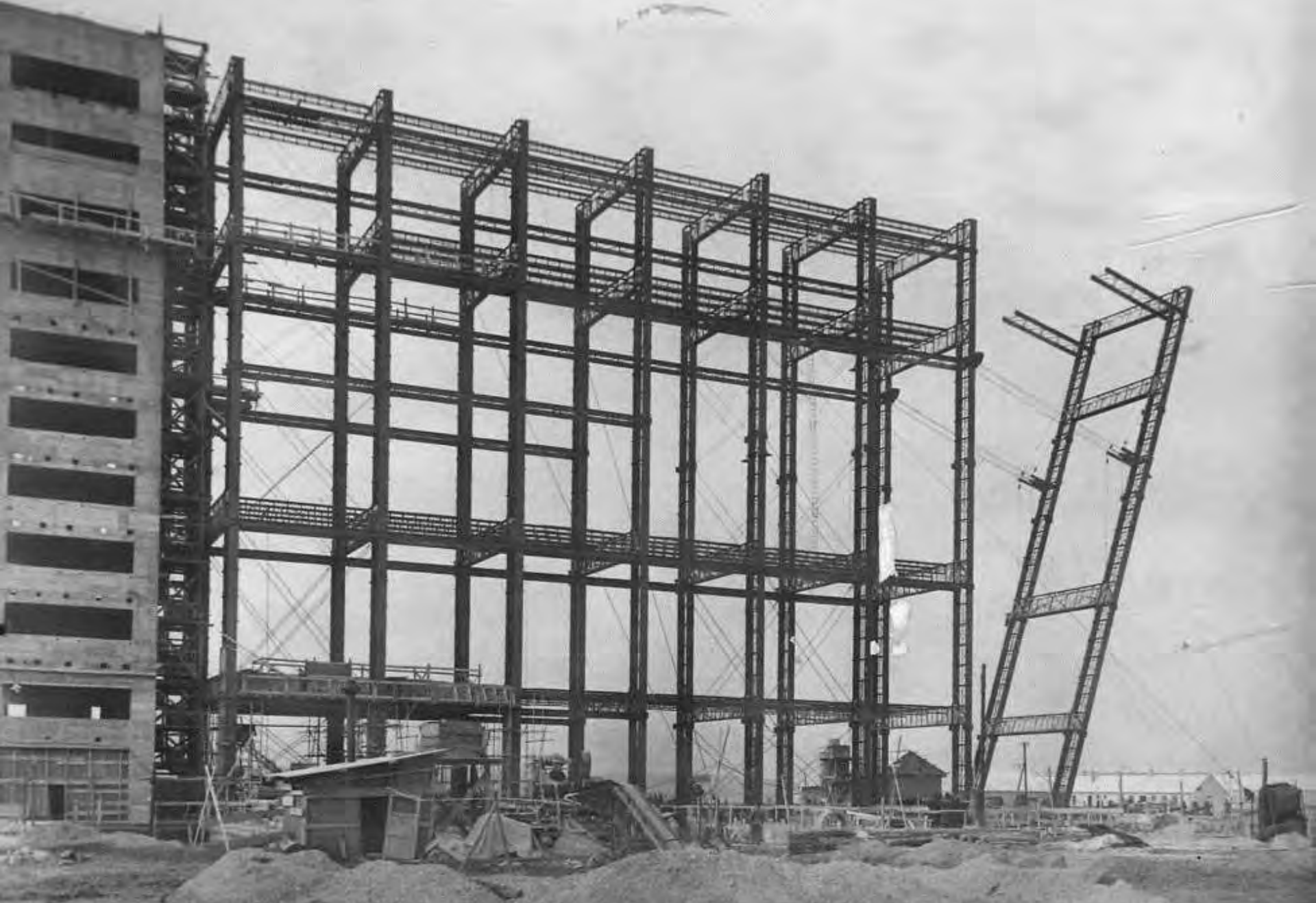
Oroszlányi hőerőmű építése, IPARTERV, Péry Vilmos, Ugrai Vilmos, Ivits Iván, építész: Bereczky László, Pomogáts József és Domaniczky Dénes, 1965
