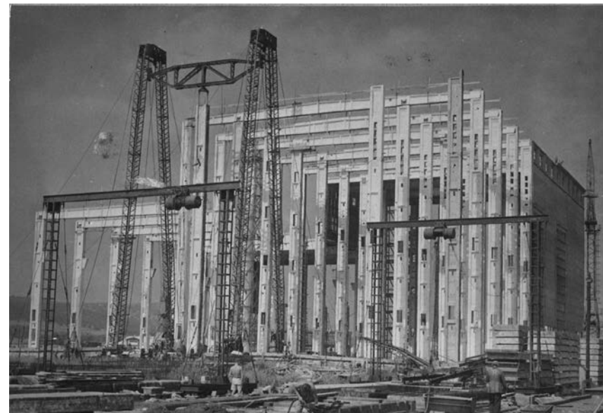
A berentei Borsodi Hőerőmű építése (1952-1954, IPARTERV, Mátrai Gyula és Pászti Károly) A rúdszerű szerkezeti elemek
