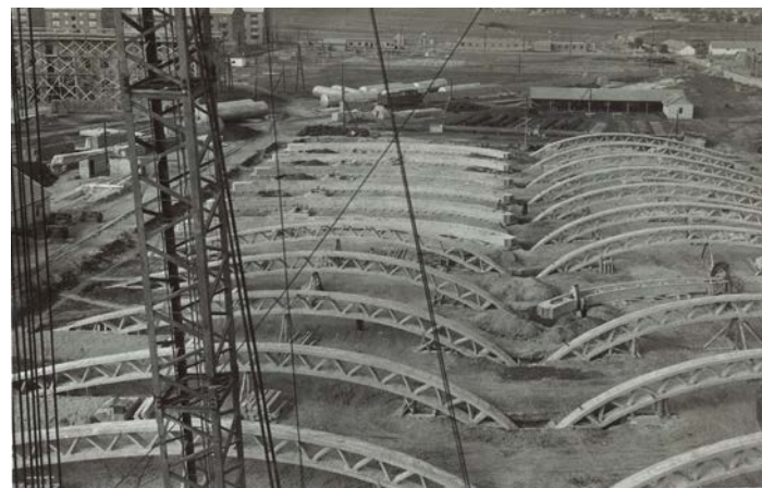
Műtrágya raktár Kazinbarcika (1952, IPARTERV, Gnädig Miklós) A háromcsuklós keret elemei. A főtartók a helyszíni betonozás után emelési helyzetbe állítva.
