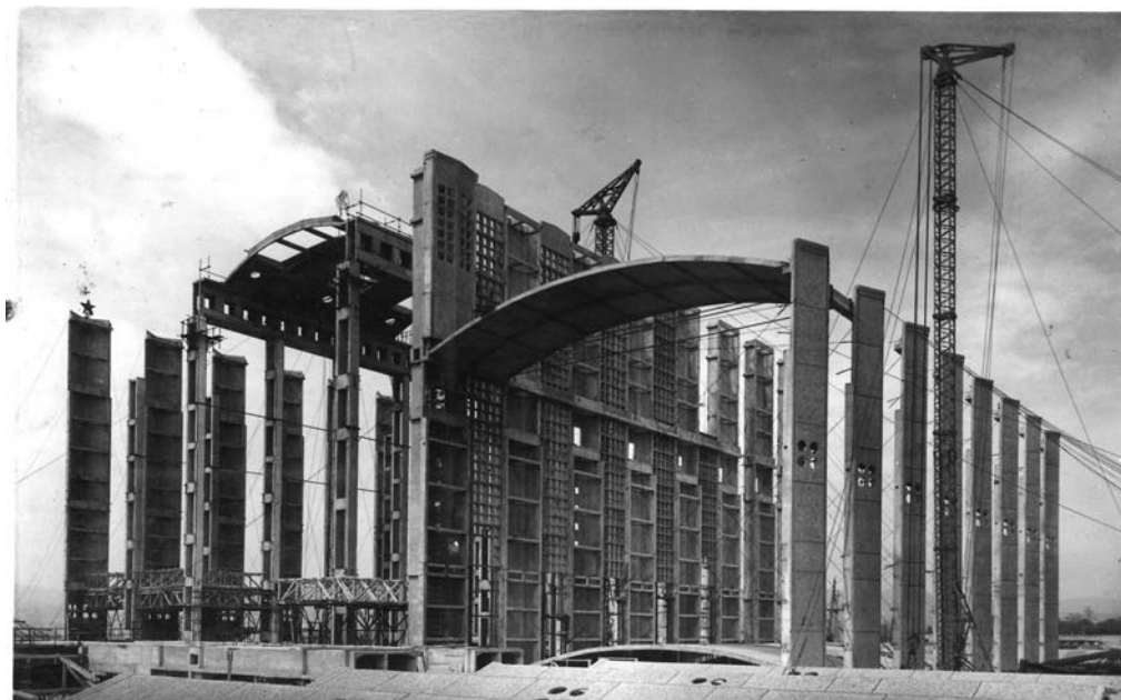
A kazánház és a gépcsarnok falpillérei állnak, elkezdődött a lefedést adó aláfeszített dongaelemek beemelése, nézet a gépcsarnok irányából
