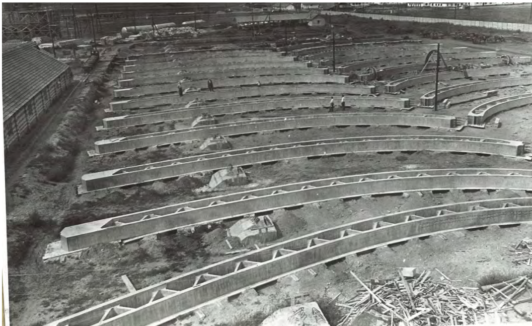
2.kép Az oldalukon fekvő vasbeton főtarók: rácsos parabola fél-ívek No. 839
