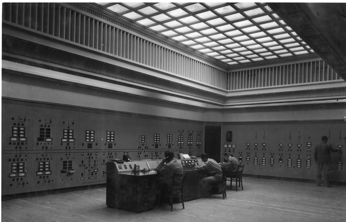
7.kép. A külön épületként megvalósult elektromos kapcsoló-vezérlő helyiség. No. 2789
